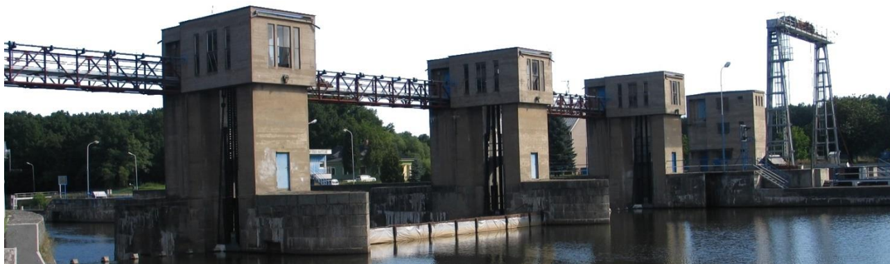
Obr. 1 VD Velký Osek, které zajišťuje výšku hladiny pro MVE Velký Osek
